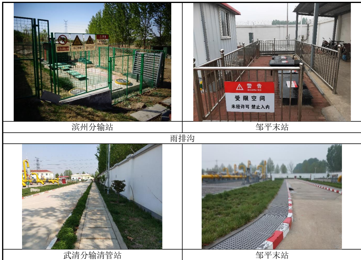
图 6.2-1 各站场污水环保设施
