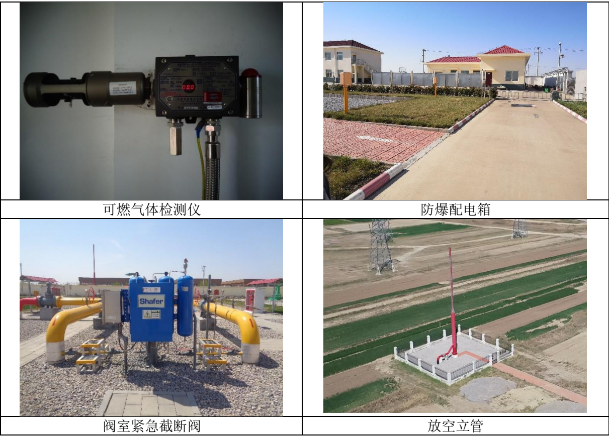
图 12.2-2 站场抢维修设施
