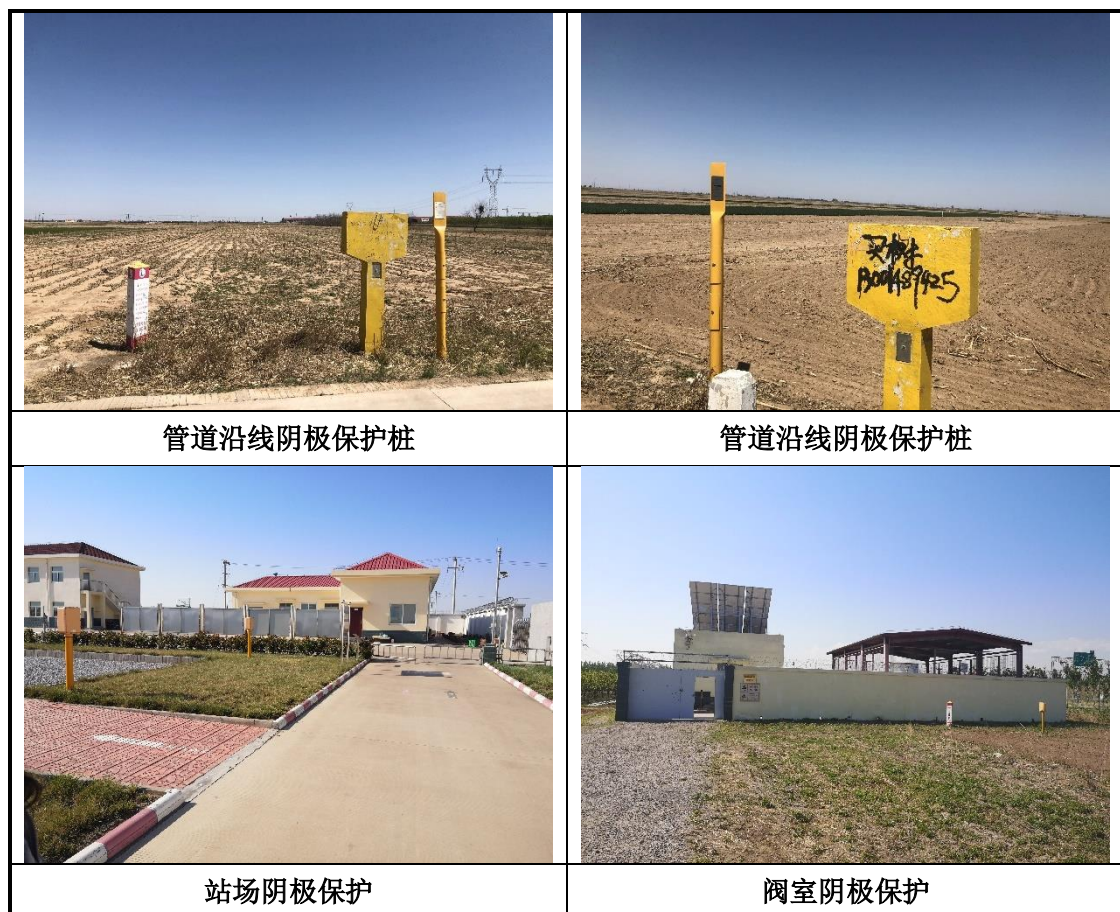
图 2.2-6 管道阴极保护设备、保护桩照片
