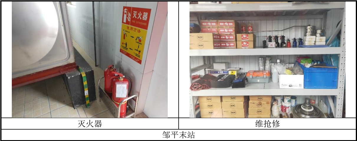
图 12.2-1 站场风险防范设施、设备
