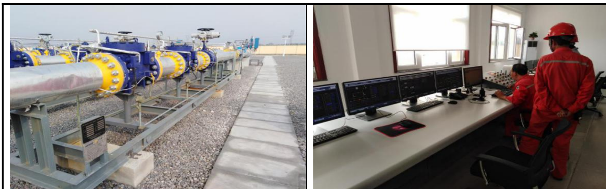
鹿泉分输清管站
